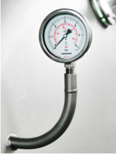
Ana Kazan Basınç Göstergesi Main Boiler Pressure Gauge
