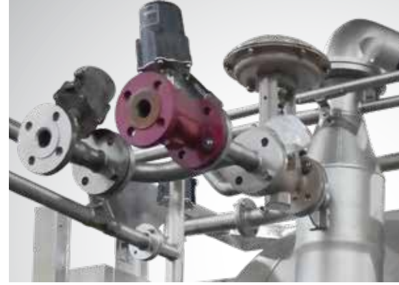
Isıtma Sistemi / Heating System
